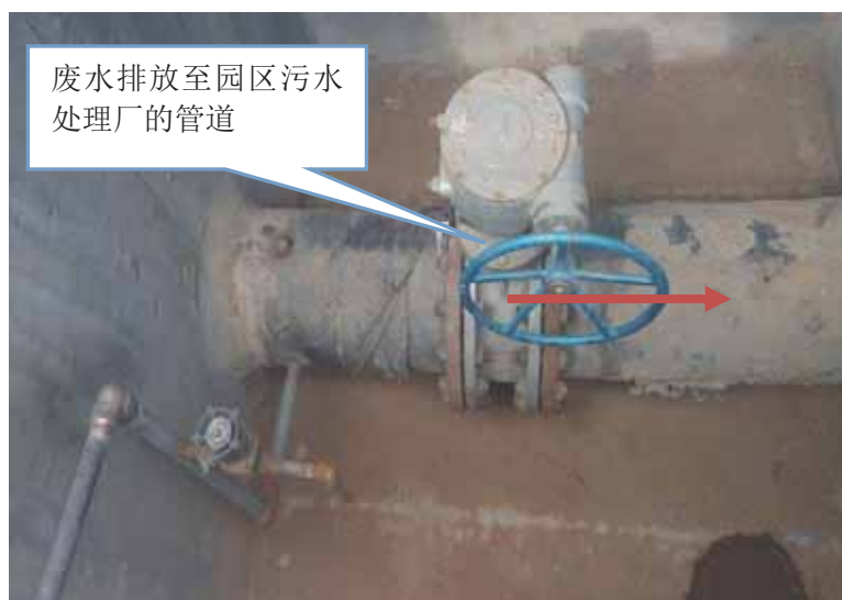
废水排放管道
