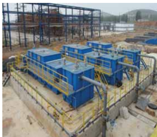
涡凹气浮装置
